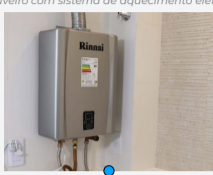
Sistema de aquecimento gás
